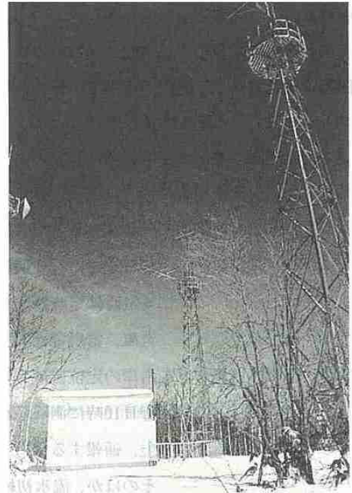
写真4 紋別山中継所（局舎と鉄塔2基）
